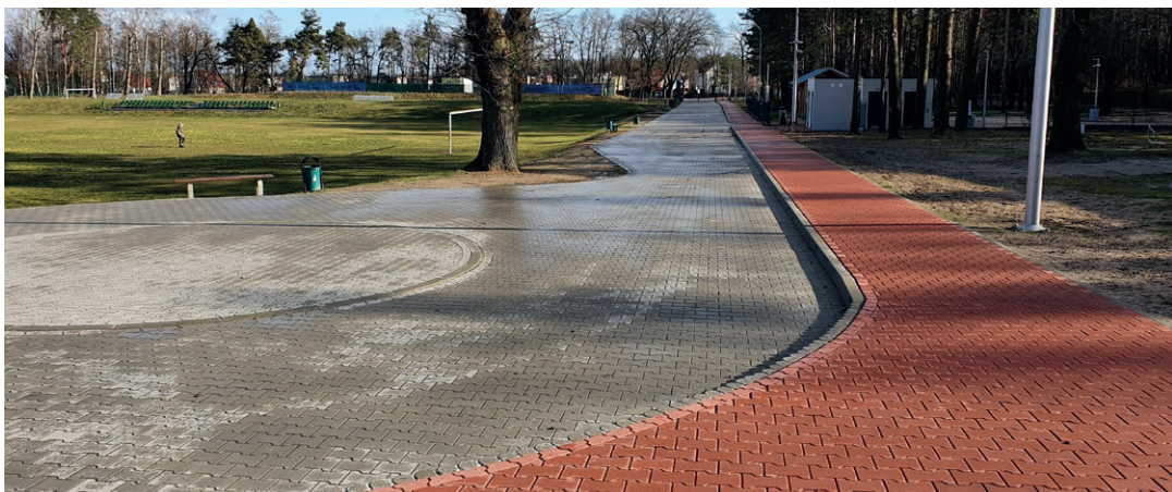
Budowa placu postojowego dla kamperów z drogą dojazdową na terenie kompleksu sportowego „Syrena”, ul. Leśna
